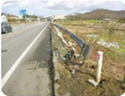
ガードレール・ 標識等の損傷
