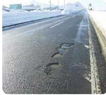
路面の穴ぼこ・ 段差
