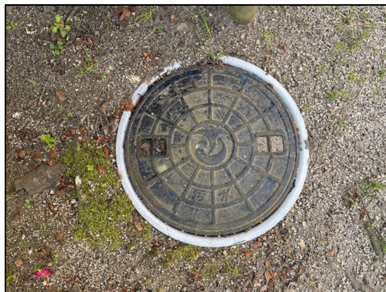
②：プラスチック製公共汚水柵(鉄蓋)
