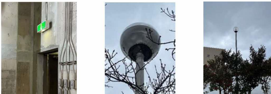
写真 4-2 LED化が必要な照明機器等
