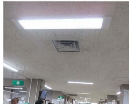
写真 3-2 照明の LED 化
