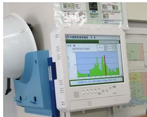
写真 3-5 電気使用量の監視
