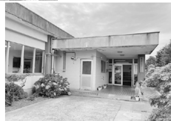
現在、学校外にある2つの児童クラブ。老朽化もあり、早期の校内移設が望まれている。
