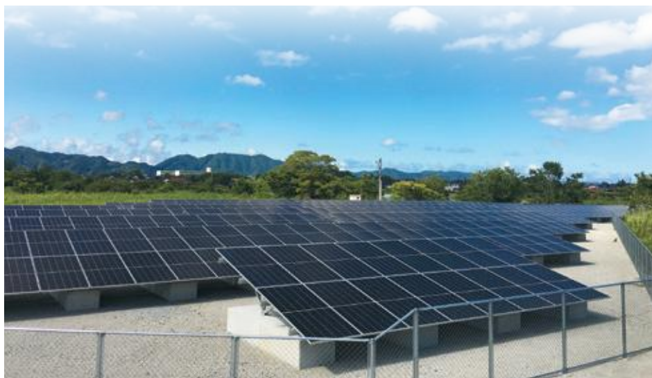
境港市渡太陽光発電所
