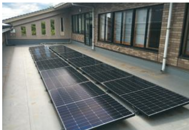
テラスに設置した太陽光パネル
