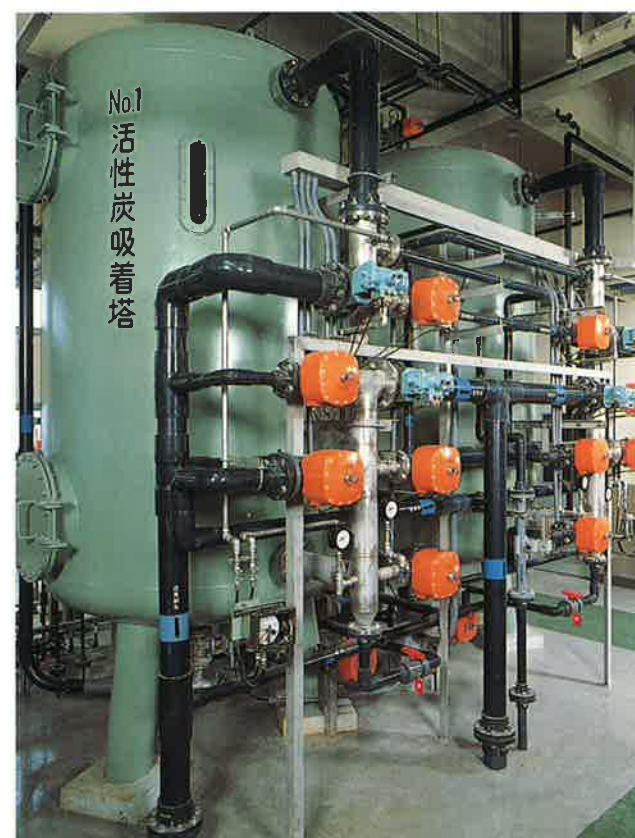
● 活性炭吸着塔
