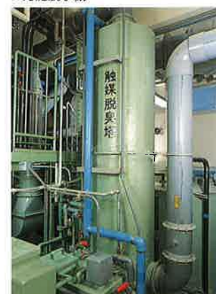
● アルカリ活性炭触媒洗浄塔
