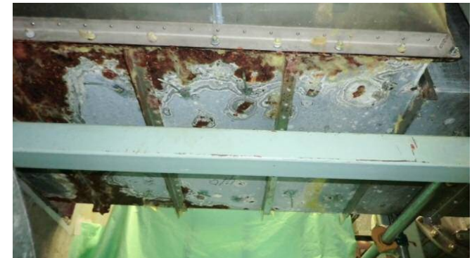
3箇所の腐食の一例
